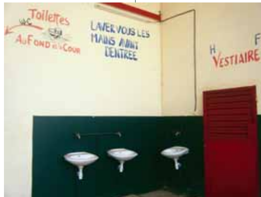
Poste de lavage des mains
